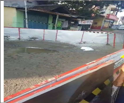
Kondisi genangan lumpur di pit 0 sta 0+000 Jl. Otto Iskandar Dinata
